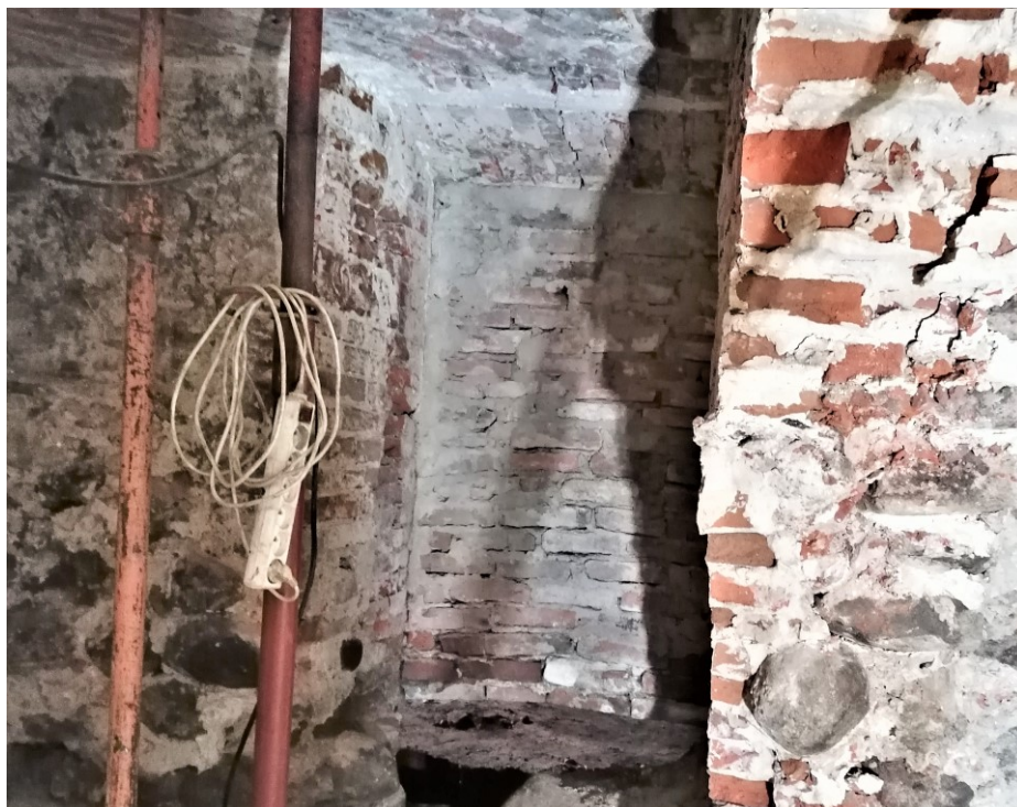
29. Ściana południowo-wschodnia w piwnicy przybudówki. Widoczny zamurowany otwór w ścianie łączącej środkową część dworu z przybudówką. Po prawej stronie widoczny fragment uciętej ściany korytarza.
