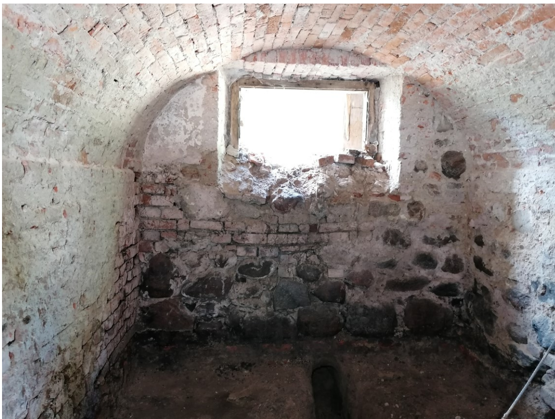
37. Skrajna piwnica północna w przybudówce. Po lewej stronie widoczne pogrubienie ściany (pierwotnie zewnętrznej?).
