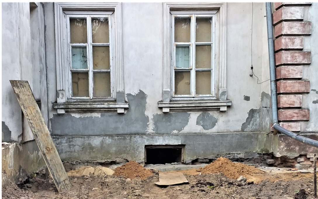
7. Fragment zachodniej elewacji dworu. Widoczna różnica pomiędzy osiami okienek piwnicy i okien parteru.
