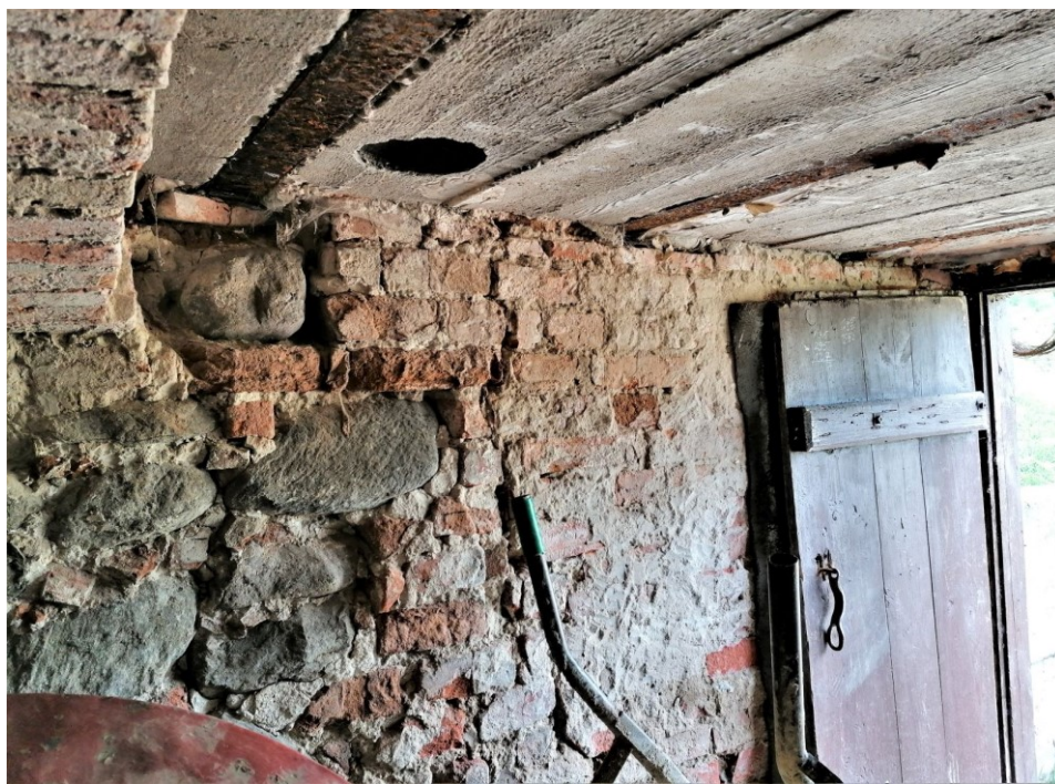
40. Wejście do piwnic w przybudówce. Widoczne wtórne przedłużenie ściany.
